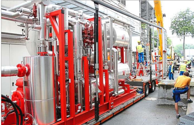
Ein Gigant: 21 Tonnen wiegt die neue Wärmepumpe, die am Mittwoch bei Verallia installiert wurde.
